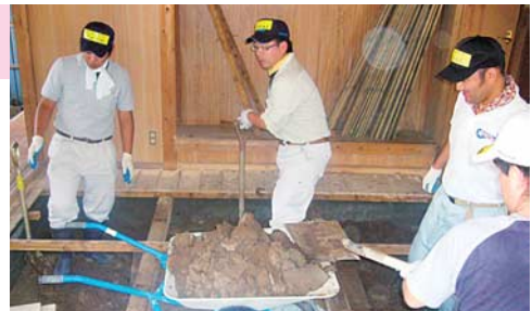
県北部豪雨災害時の 災害ボランティア活動の様子（さつま町）
